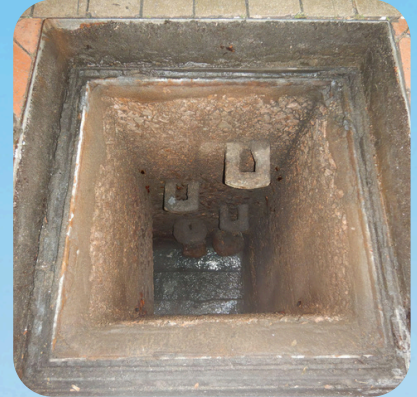
沙井內部狀況檢測
